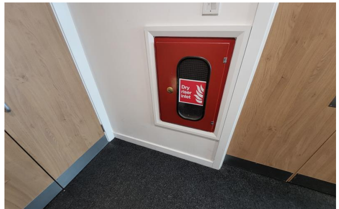
Dry riser outlet.
