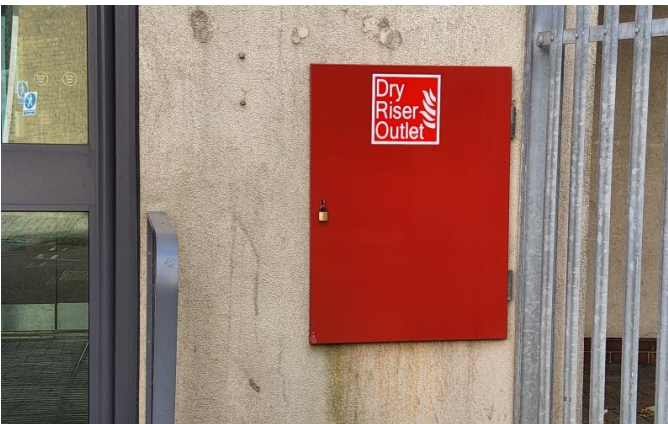
Dry riser inlet.
